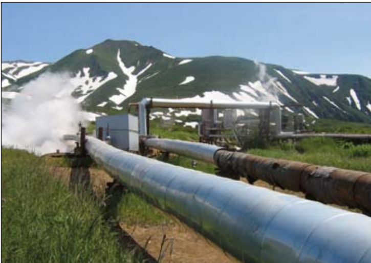
Рис. 3. Трубопровод, доставляющий пароводяную смесь от эксплуатационной скважины на Паужетскую геотермальную станцию
